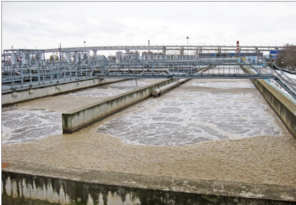
Фото 8. Аэротенк Центральной станции аэрации
