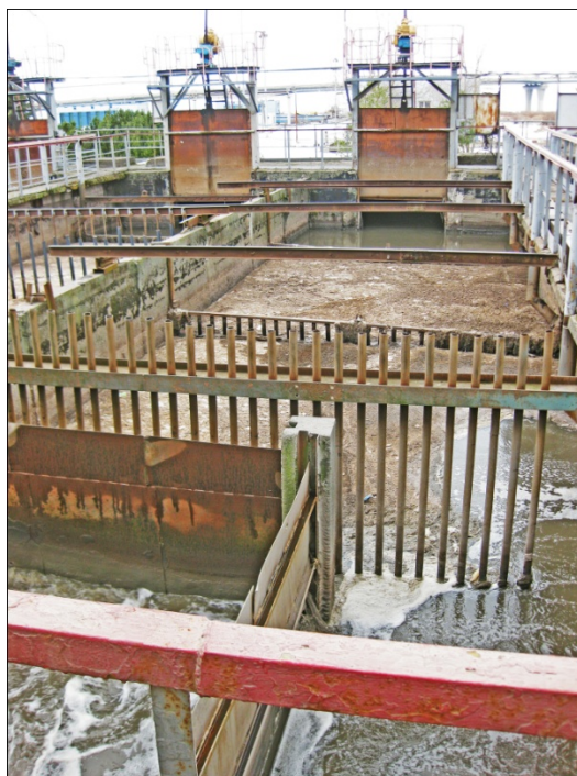
Фото 6. Песколовки, загрязнения с положительной плавучестью
