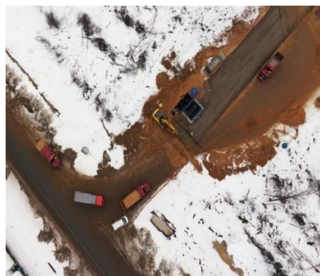
Рис. 2. Съезд с подъездной дороги по состоянию на 11:52 11.02.2022 г.
