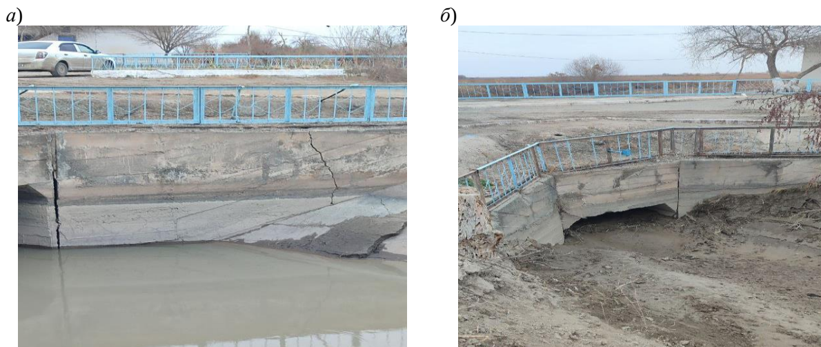
Рис. 2. Процессы, происходящие в канале: а – образование трещин в сооружении канала; б – заиление канала перед сооружением
